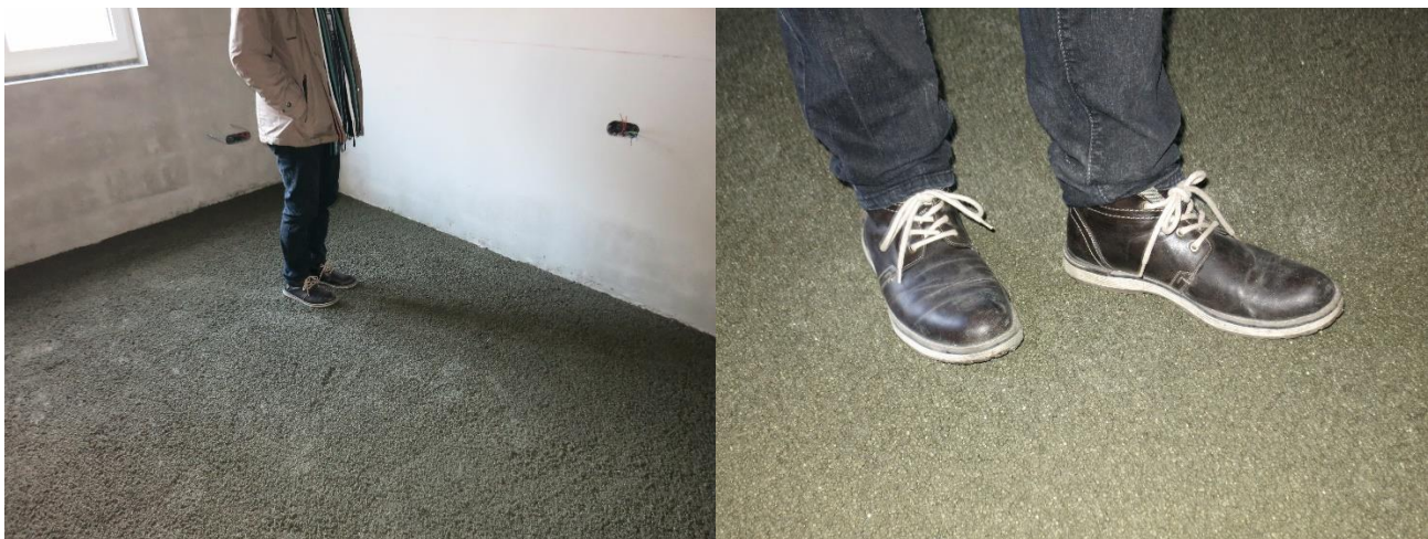
Versuchsbaustelle Gallizien: Außentemperatur -7°C, Raumtemperatur +5°C, Begehbarkeit und damit Belegereife nach 24 h
